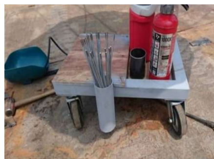
消火器・水筒・溶接棒がすぐ手に届く場所に設置できている
