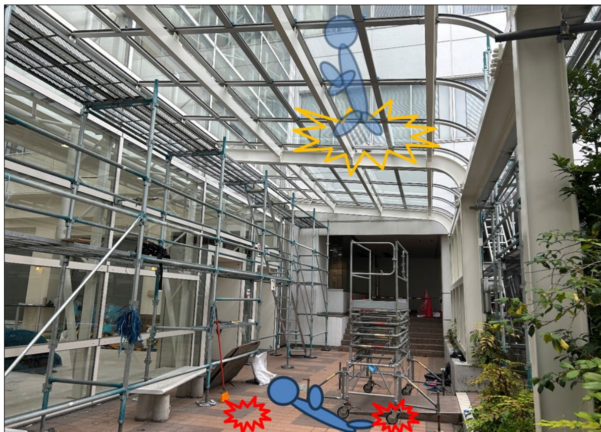
ガラス屋根のガラスが割れ墜落
