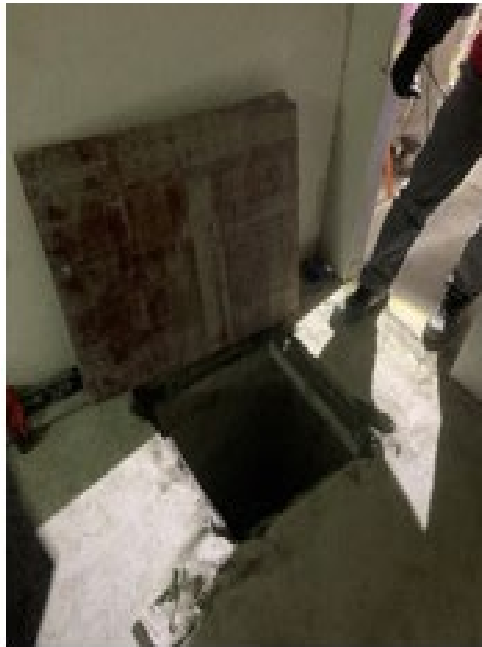
墜落した時のマンホールの状況
