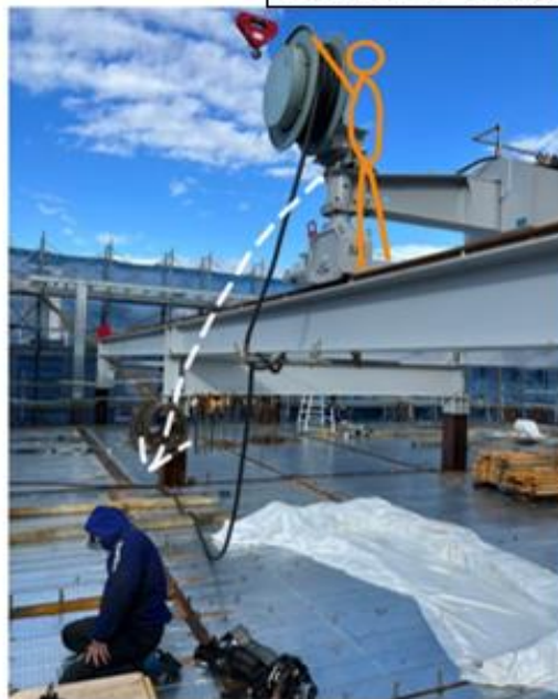
災害発生時の状況
