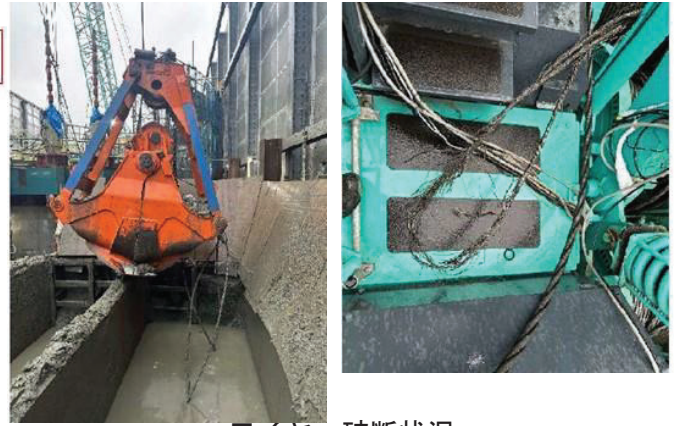
ワイヤー破断状況
