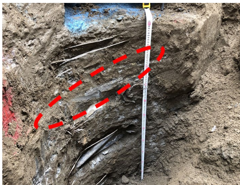
損傷状況 写真
